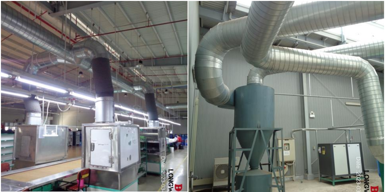
Hình 3.12. Hình ảnh hệ thống xử lý hơi keo nhà xưởng F27-2
