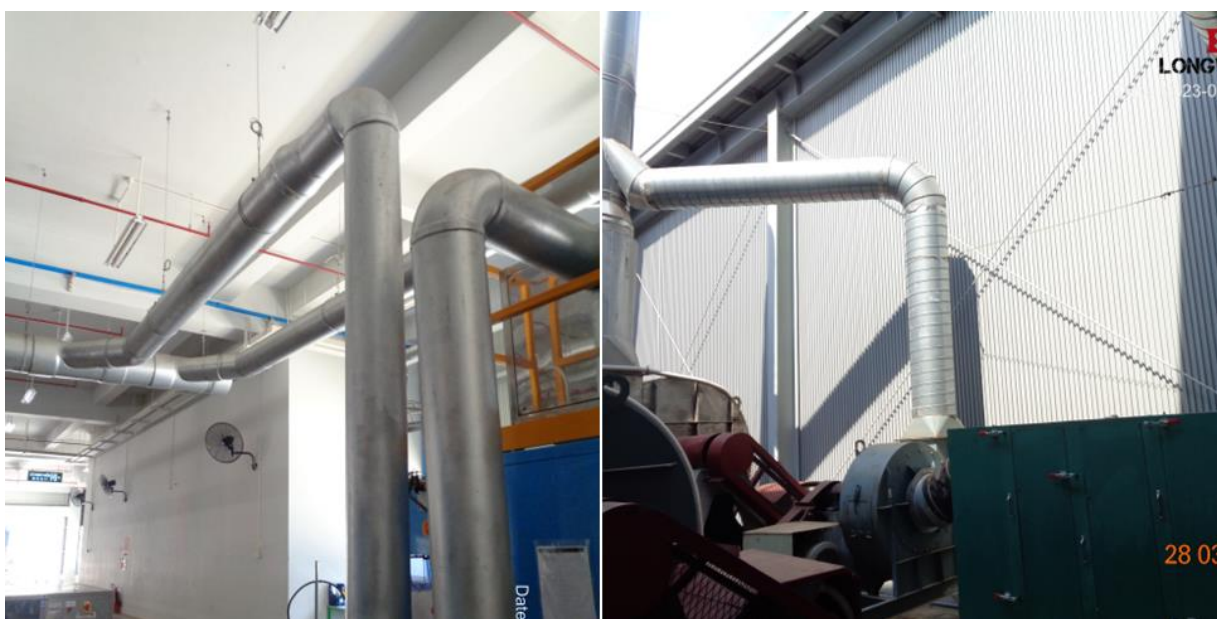
Hình 3.14. Hình ảnh hệ thống xử lý hơi keo nhà xưởng F27-4
