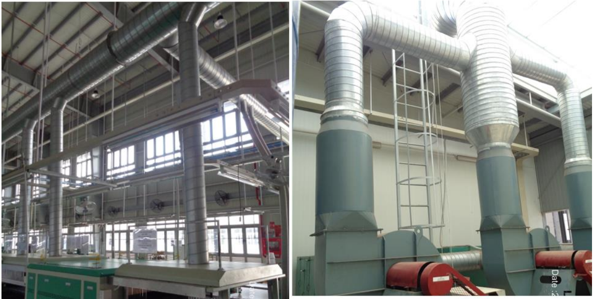
Hình 3.9. Hình ảnh hệ thống xử lý hơi keo nhà xưởng F23
