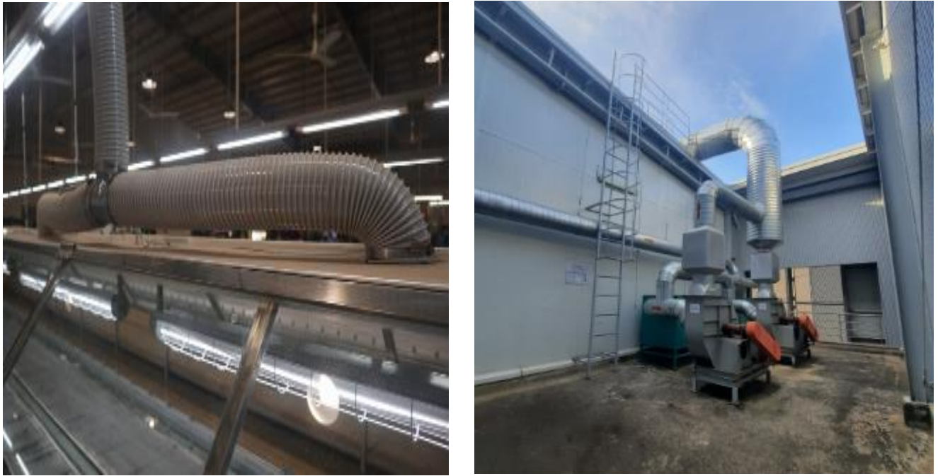
Hình 3.7. Hình ảnh hệ thống xử lý hơi mực in nhà xưởng F22
