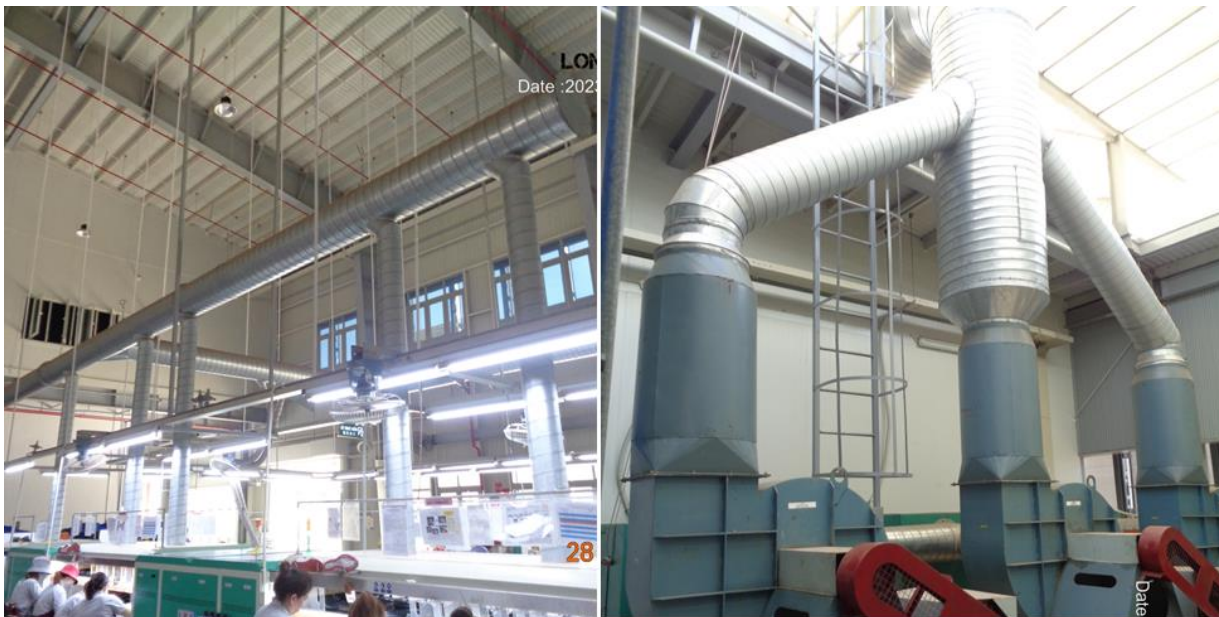
Hình 3.15. Hình ảnh hệ thống xử lý hơi keo nhà xưởng F28
