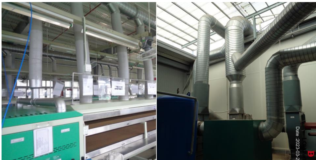
Hình 3.11. Hình ảnh hệ thống xử lý hơi keo nhà xưởng F27-1
