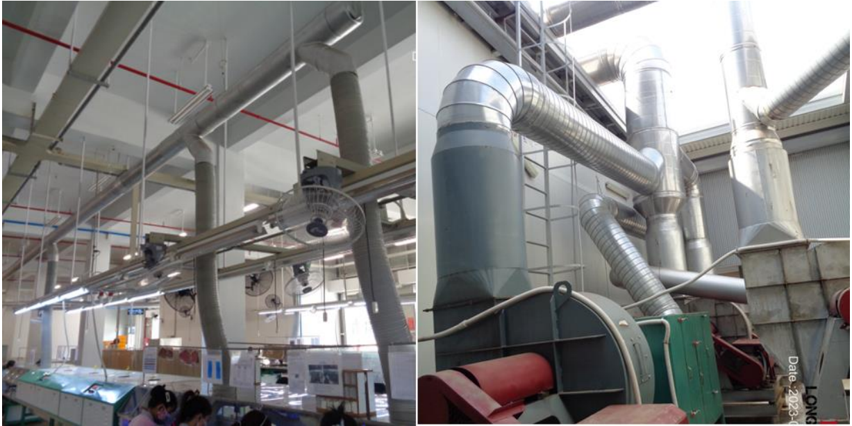
Hình 3.13. Hình ảnh hệ thống xử lý hơi keo nhà xưởng F27-3
