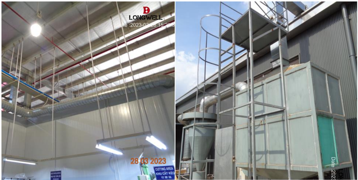
Hình 3.16. Hình ảnh hệ thống xử lý hơi keo nhà xưởng M6-1
